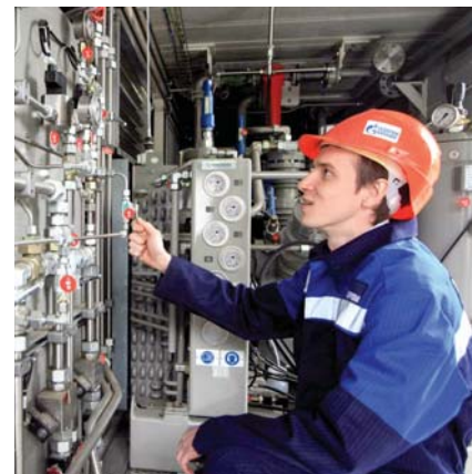
Проверка оборудования на АГНКС
