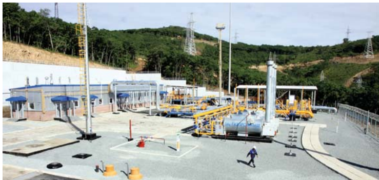
Современная газораспределительная станция во Владивостоке – один из объектов ГТС Сахалин – Хабаровск – Владивосток
